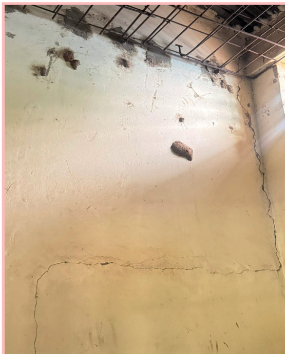
Salle de GAV de la BP de Pekesse
