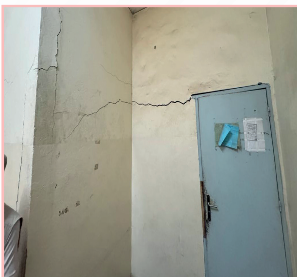
Mur fissuré bureau enquêteurs CC Kaolack
