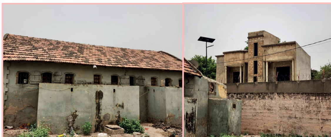
État des dortoirs de la MAC de Tivaouane
