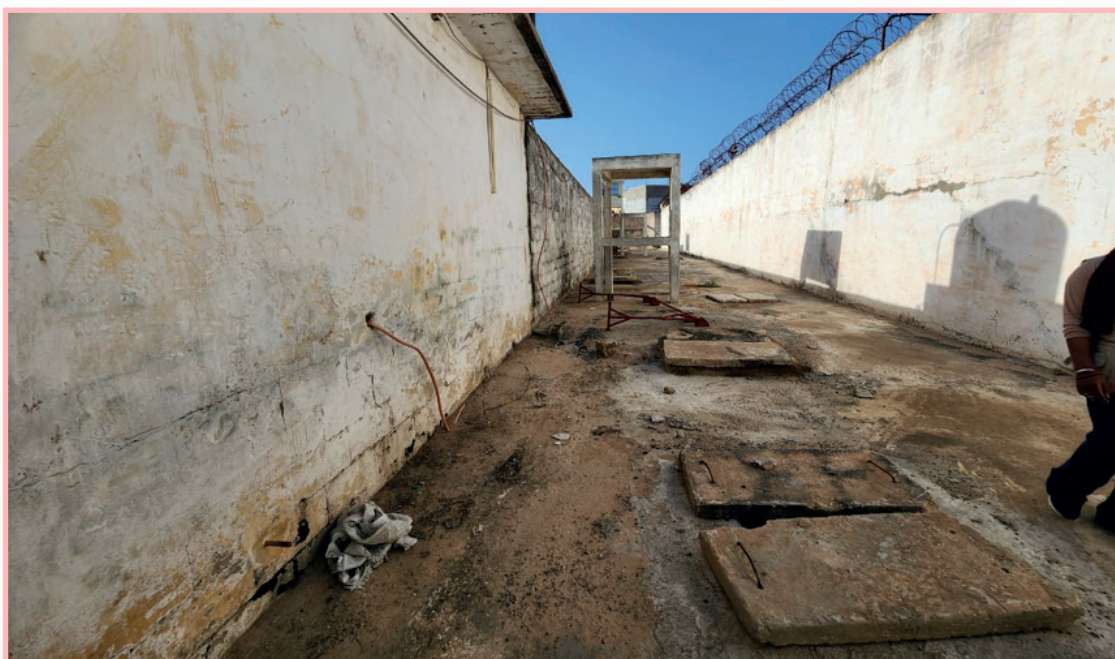
Système d'assainissement défaillant du Camp Pénal liberté VI
