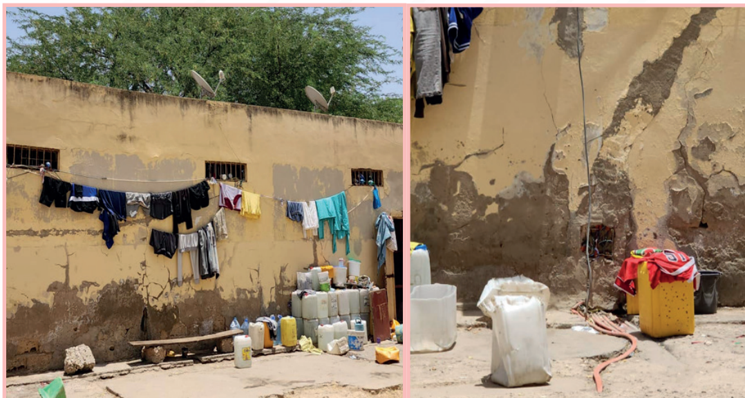
Murs fissurés des dortoirs de la MAC de Foundiougne
