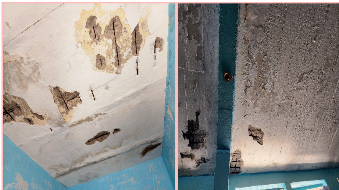
État inquiétant de la toiture des bâtiments de la grande détention du Camp Pénal de liberté VI
