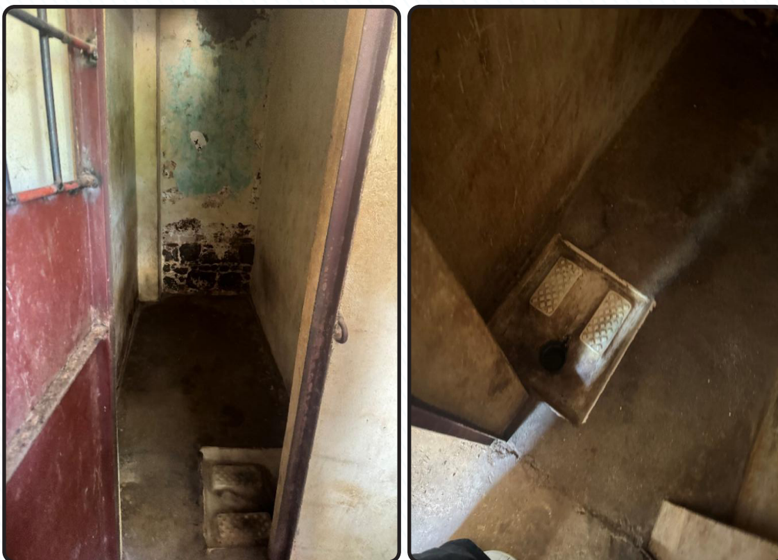
État déplorable des cellules disciplinaires de la MAC du Cap Manuel
