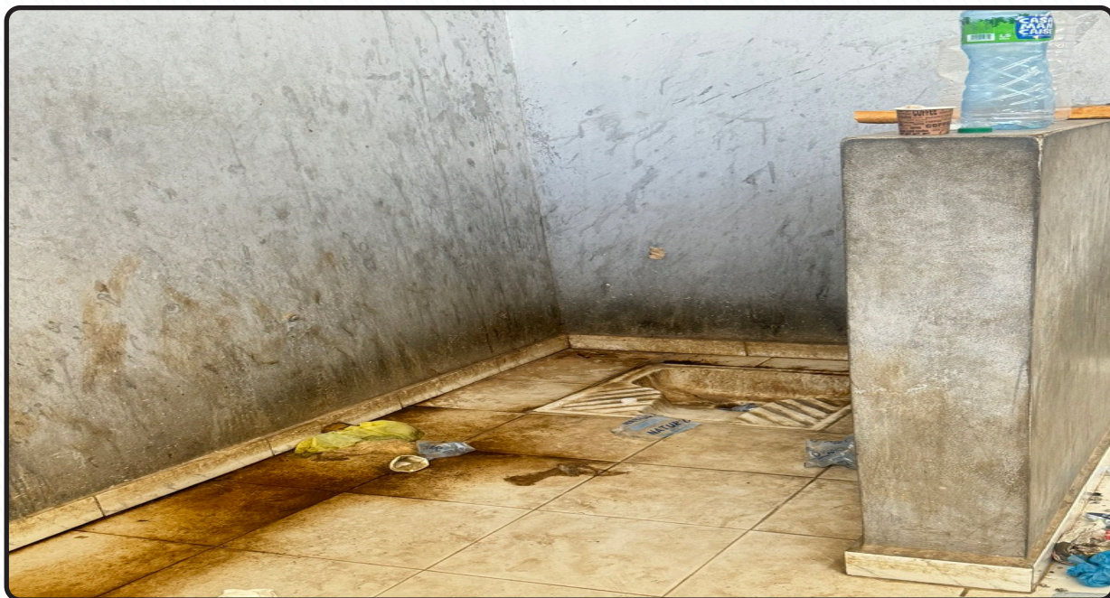
Etat insalubre d'une salle de GAV au CA de Golf Sud
