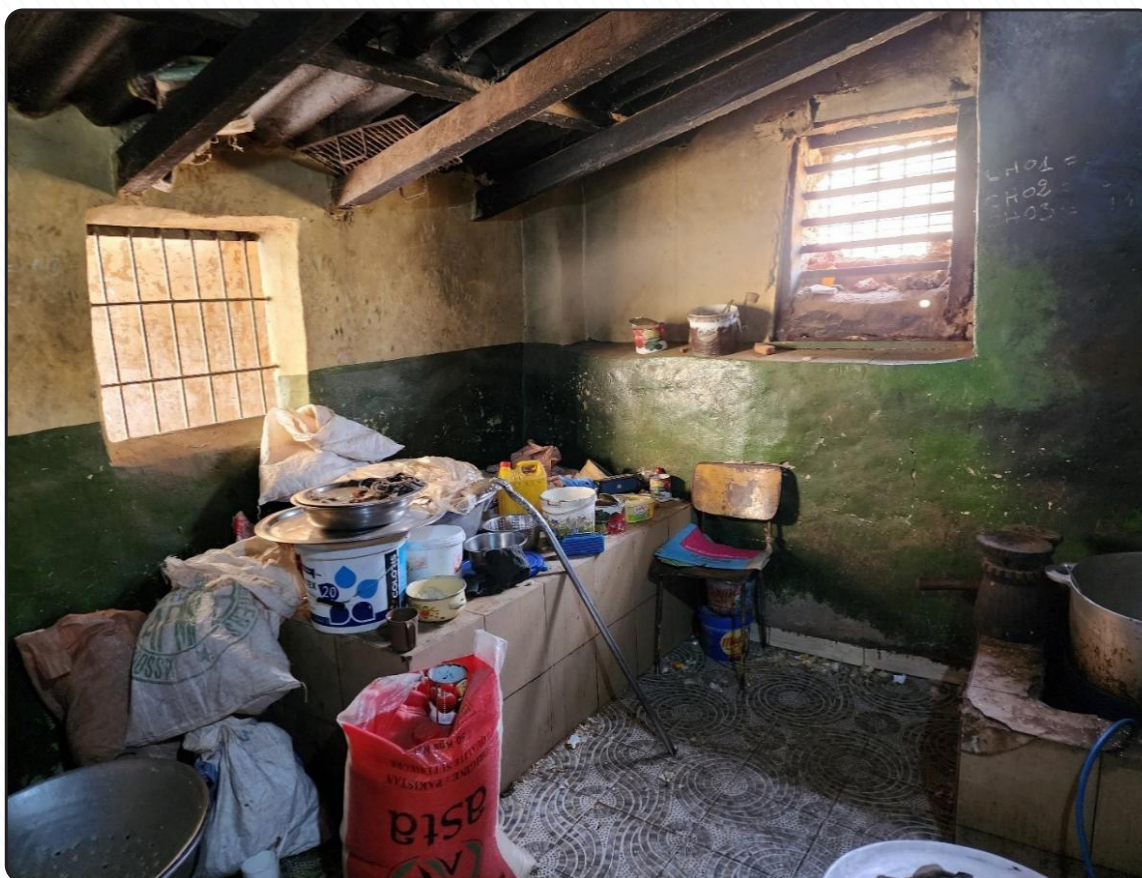
Cuisine de la MAC de Bakel en mauvais état
