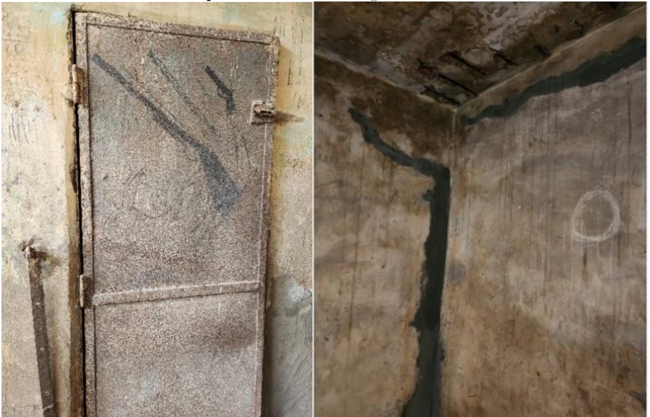
Cellule disciplinaire MAC de Kaffrine avec porte pleine en fer et toiture perméable aux infiltrations d'eau
