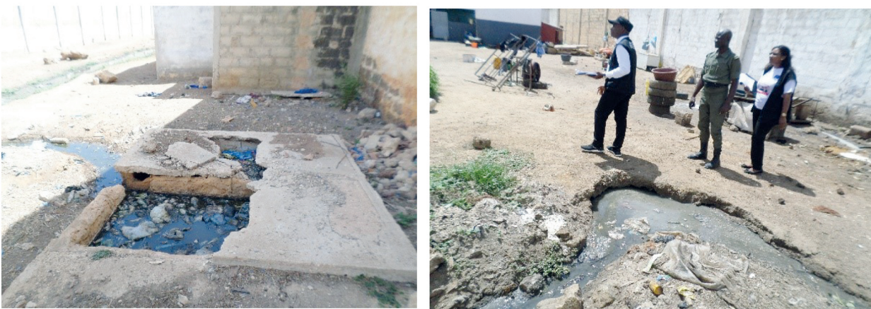
Etat des fosses septiques de la MAC de Thiès (IMG du 14/05/2019)
