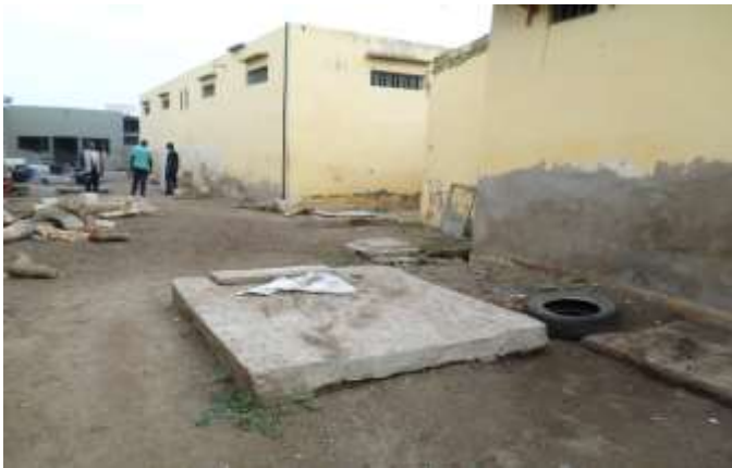
Vue extérieure d'une fosse septique intérieure
